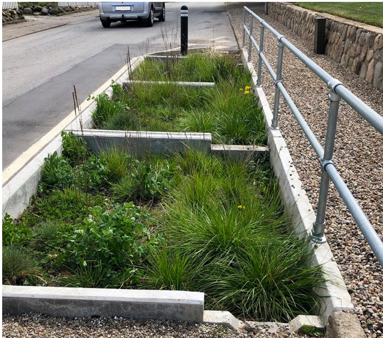
Billedet viser et LAR-anlæg i vejarealet i Kliplev, hvor regnvand håndteres gennem et beplantet regnbed. Det illustrerer et konkret element i et vandhåndteringssystem, som kræver løbende drift og vedligeholdelse. ARWOS har her ansvaret for drift- og vedligehold da det er på offentligt vejnet.
