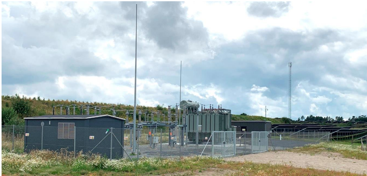
Foto af en typisk step-up transformer. De høje master inden for indhegningen er lynafledere.
