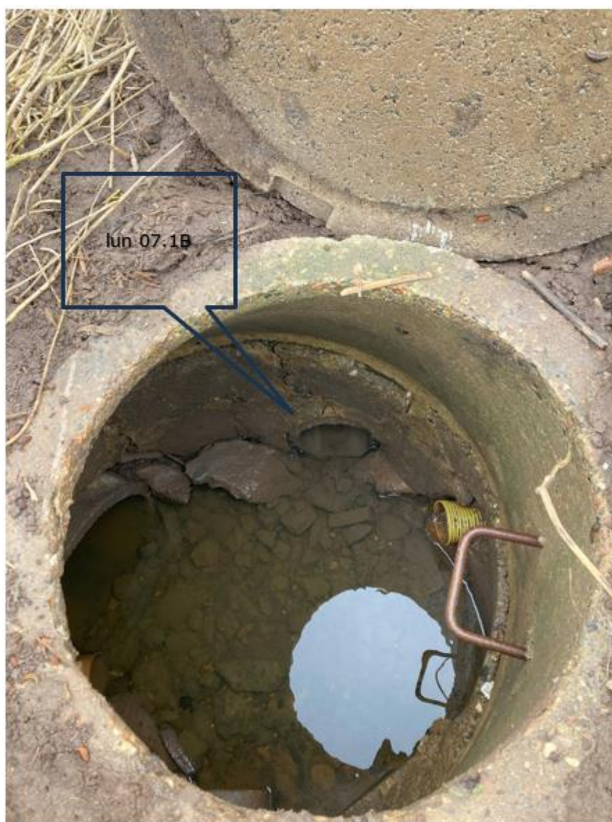
Figur 3: Billede fra tilsyn af brønden.
