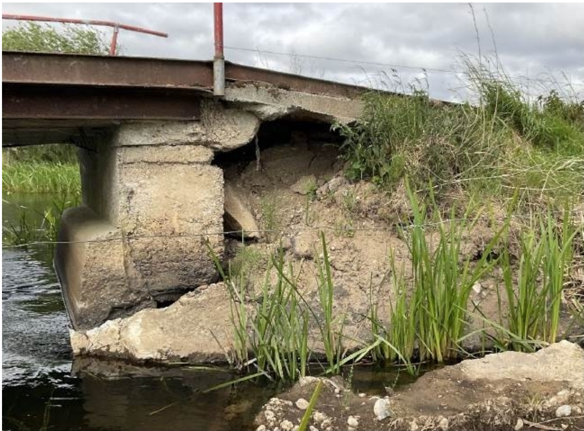
Figur 1: Dette foto fra ansøgningsmaterialet viser tydeligt hvordan broen undergraves som følge af erosion i forbindelse med især høje vandføringer i vandløbet.
