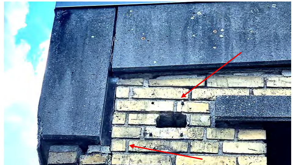
Spalter ved tagkonstruktion og manglende mursten, måske tidvise opholdssteder for flagermus
