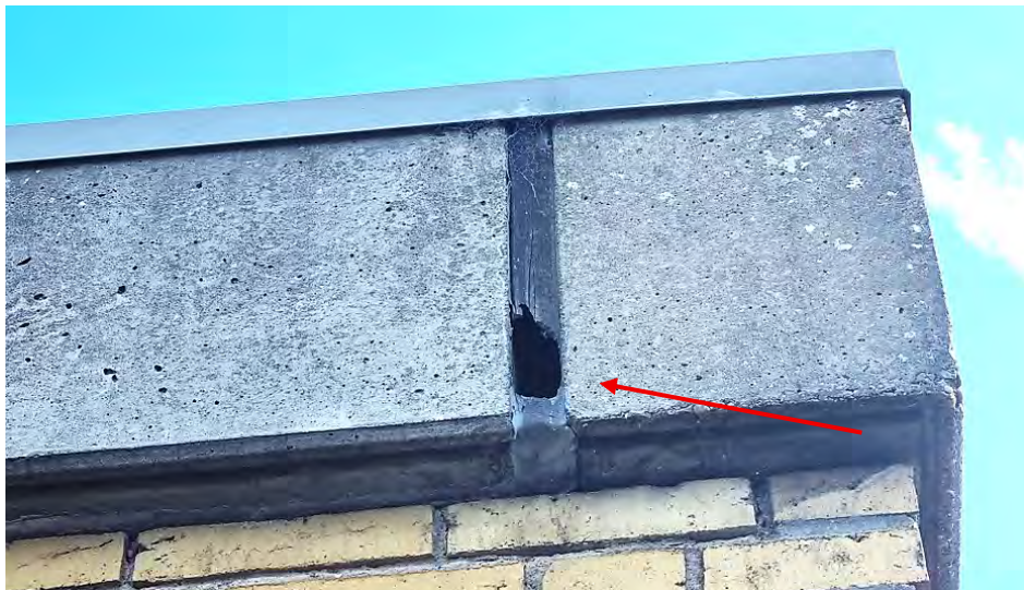
Hulhed i spalte ved tagkonstruktion, måske et tidvis rastested for flagermus.
