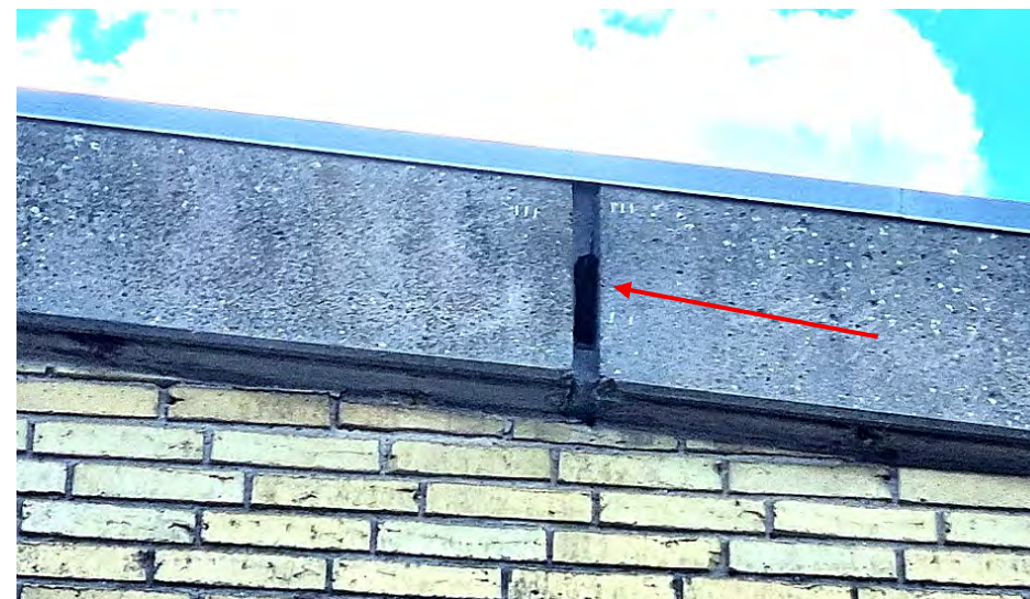
Hulhed i tætningsmasse mellem betonblokke mod tagkonstruktion.
