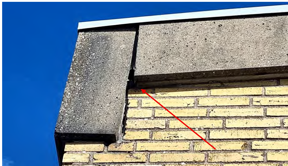
Spalter ved murværk mod tagkonstruktion, måske tidvise opholdssteder for flagermus
