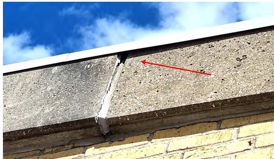
Spalter ved tagkonstruktion, måske tidvis opholdssted for flagermus
