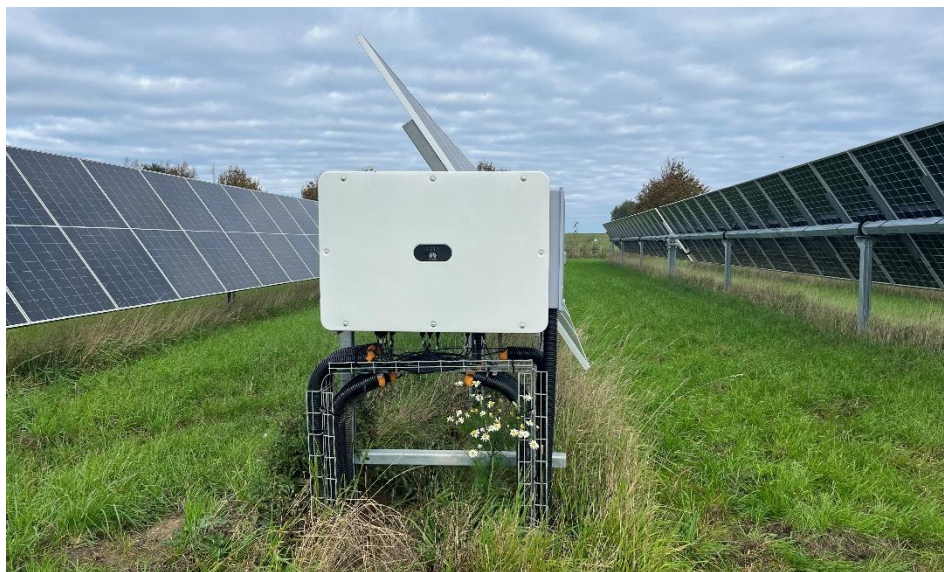
Figur 6-10 Eksempel på inverter, der her indgår i et solcelleanlæg med solcellepaneler på trackere. Valget af de endelige typer af teknisk udstyr sker først i projekteringsfasen.
