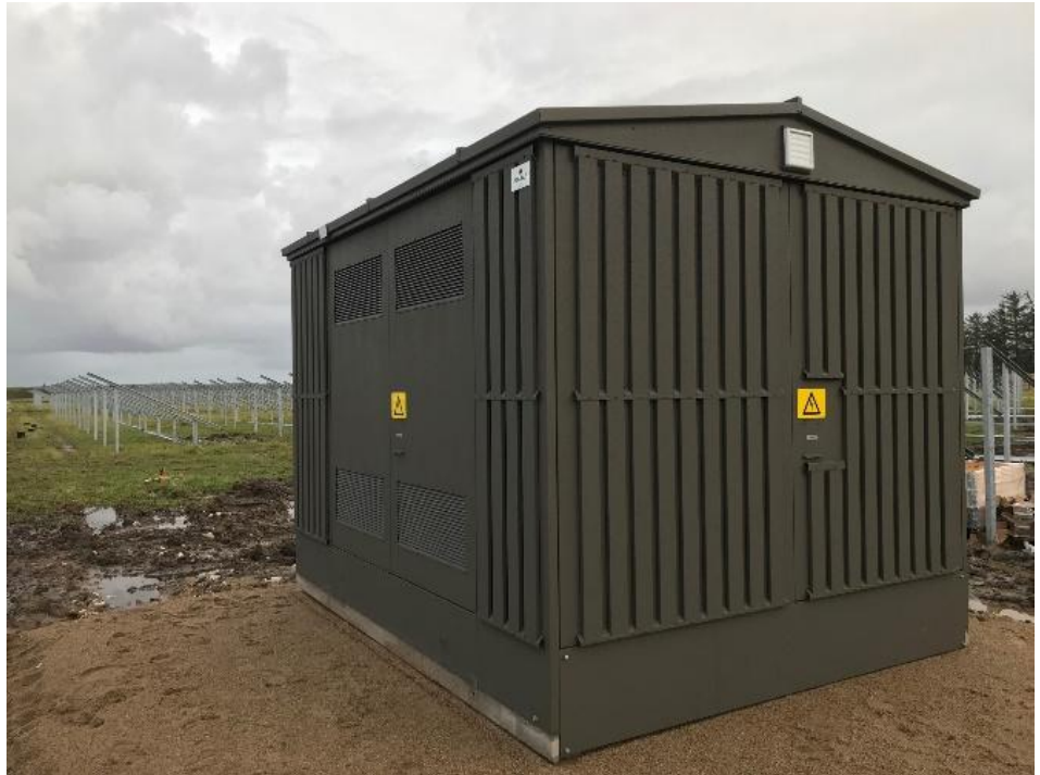
Figur 6-9 Eksempel på fordelingstransformer.
