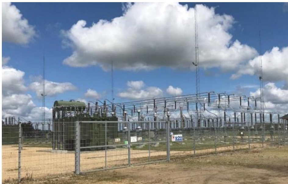
Figur 6-11 Eksempel på transformerstation med effekttransformeren til venstre og forskellige udendørs installationer..
