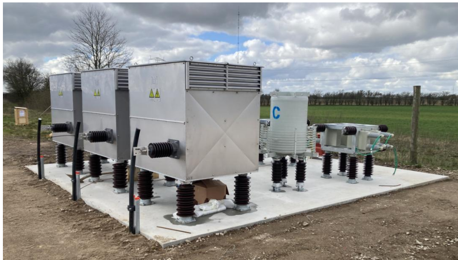
Figur 6-12 Eksempel på harmoniske filtre placeret inden for arealet til transformerstationen.
