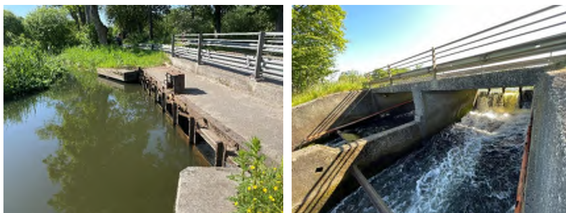
Figur 5 Stemmeværk på opstrøms (tv) og nedstrøms side (th) af Julianehåbvej
