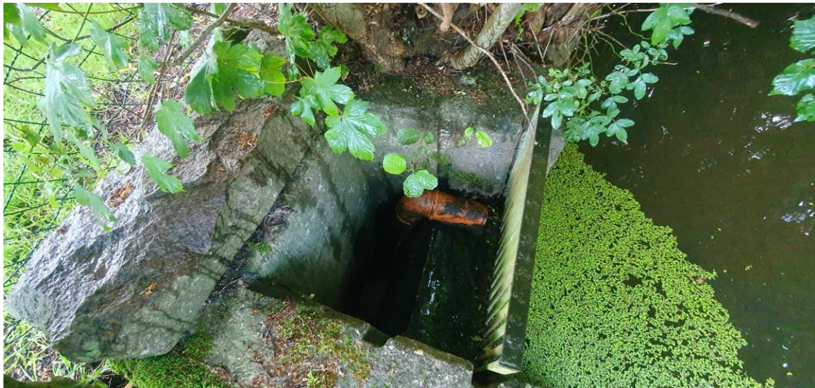
Figur 6 Udløb af Farversmølle sø via stemmeværk. Faldet ud af er ca. 3-3,5 meter og ikke passabel for vandløbets fauna.
