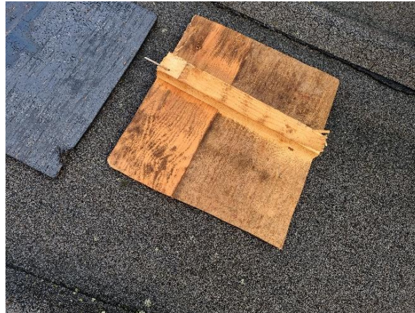
Figur 7 Tag afsnit 7 skrå tagflade, TI prøve P12. Underside af krydsfinér med kraftig skimmel og højt fugtindhold.
