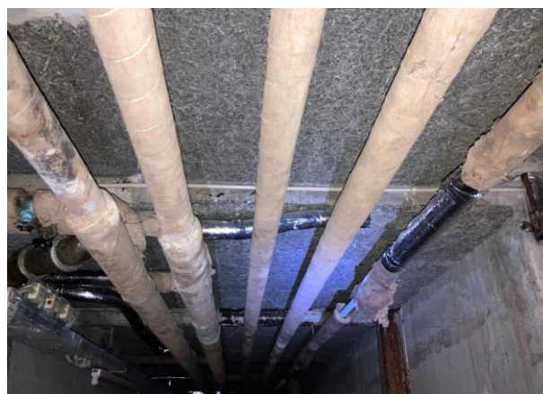
Figur 12 Skimmelvækst på teknisk isolering i bygning 7 (område D).
