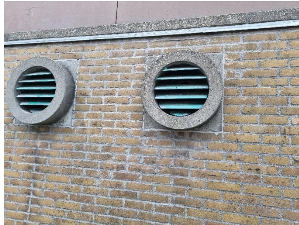
Figur 11 Åbninger i facader ved bygning 7.
