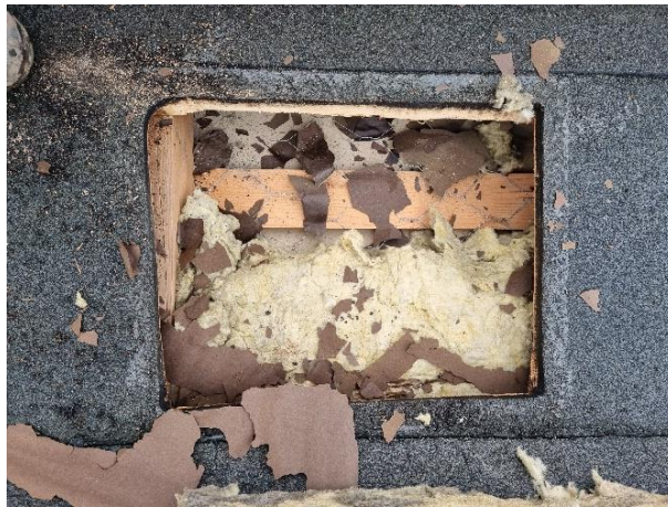
Figur 5 Tag afsnit 7 skrå tagflade, TI prøve P1. Ingen dampspærre i tagkonstruktion. Der kan også konstateres kraftig skimmel på underside af krydsfinér.
