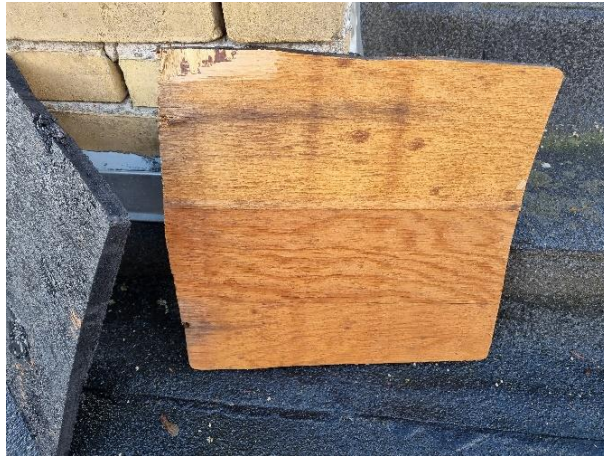
Figur 4 Tag afsnit 1 fladt tag, TI prøve 49. Underside af krydsfinér med skimmelvækst og højt fugtindhold.
