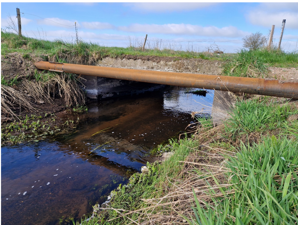
Figur 3: Samme krydsende ledning set i medstrøms retning.
