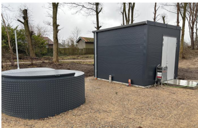
Figur 2.7: Eksempel på pumpestation
