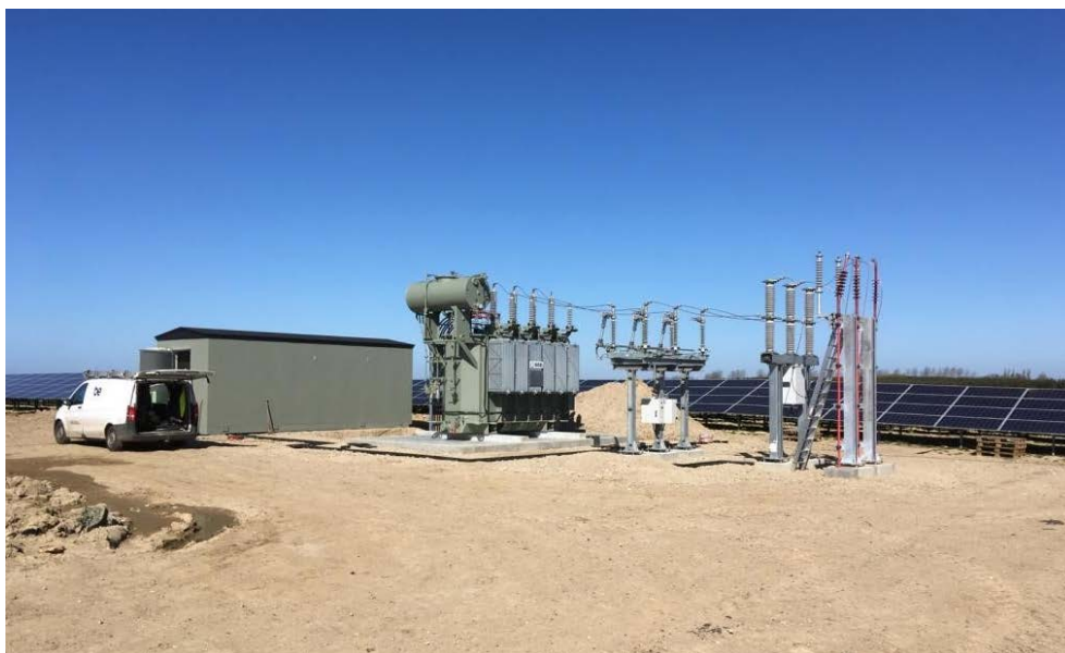
Figur 4-4: Stepup-transformer og teknikhus.
