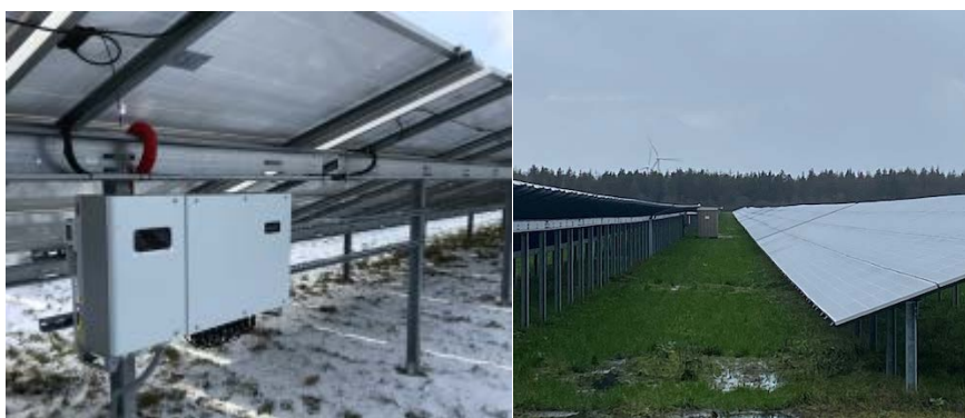
Figur 1-6: Invertere placeres under solenergipanelerne. Transformere placeres spredt i området og skjules under solenergipanelerne. Foto: Better Energy.
