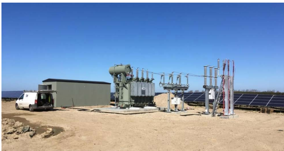
Figur 1-7: Stepup-transformer og teknikhus. Foto: Better Energy.
