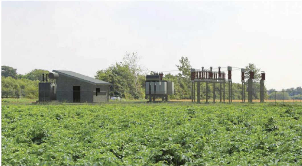
Figur 5.2: Eksempel på step-up transformer omkranset af trådhegn, inden separat beplantning er etableret.
